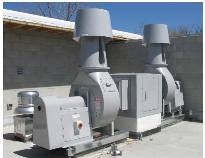
Lab exhaust fan
